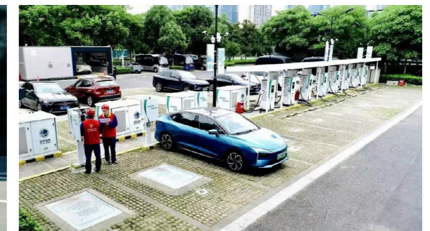
国家电网杭州萧山亚运村充电站
