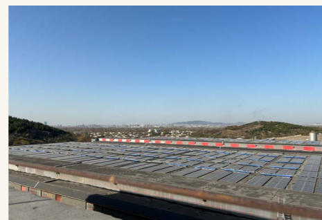
>> 东山北区屋顶光伏
