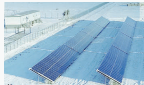
巴尔喀什湖畔100MW光伏电站
