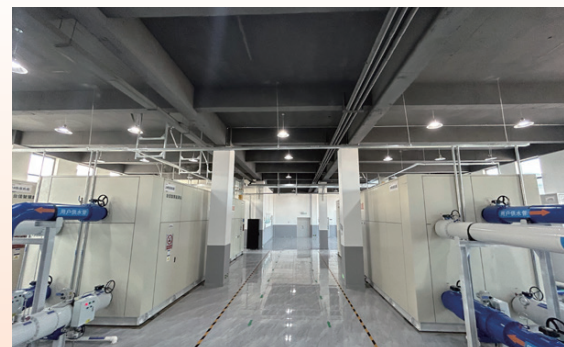
地热供暖示范项目运行设备
