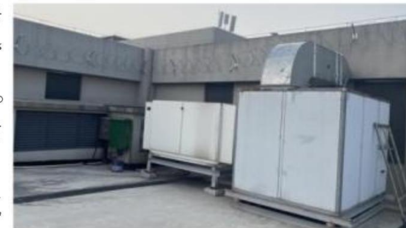
废气处理设施-活性炭吸附
