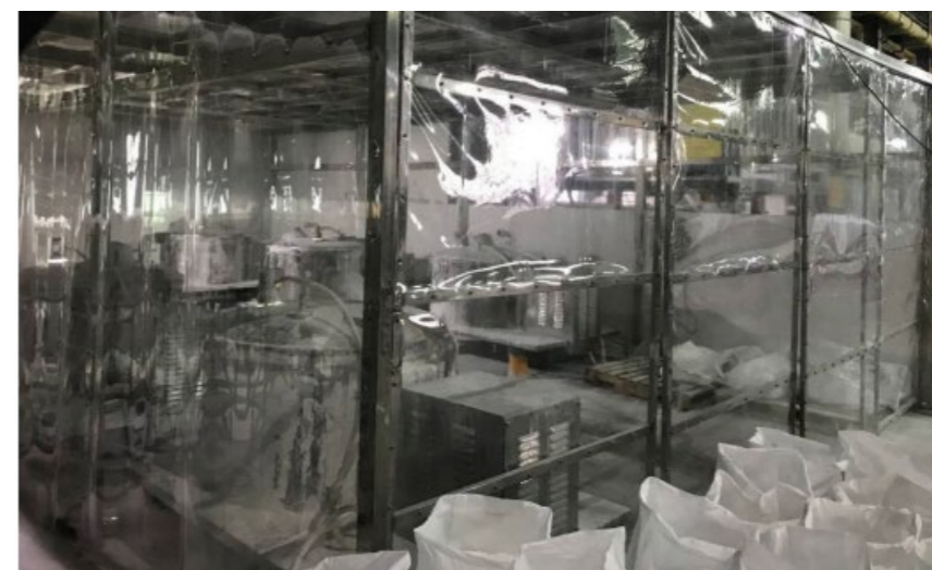
方案实施后化工一车间离心工序密闭装置照片
