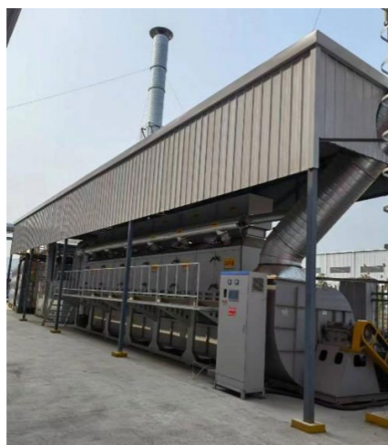
图：在线催化燃烧环保处理设施
