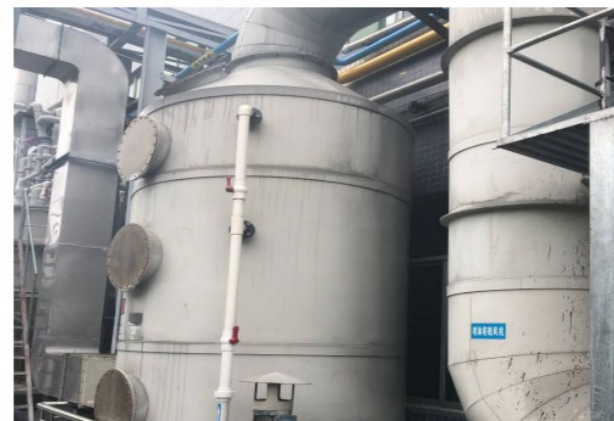
方案实施前使用的水喷淋装置
