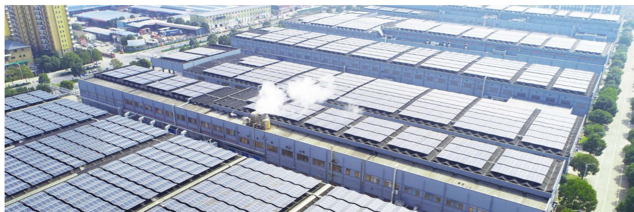
公司安装的光伏板
