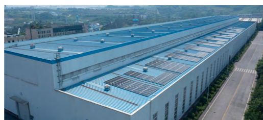
“蓝帆工程”屋顶分布式光伏
