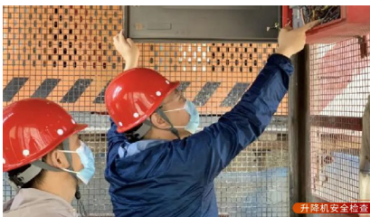
升降机安全检查
