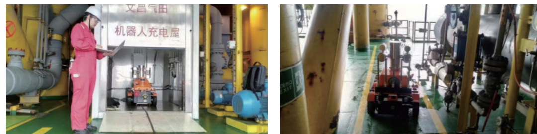
海上平台机器人巡检，数据通过5G专网实施回传
