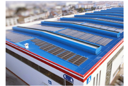
公司厂区光伏屋顶
