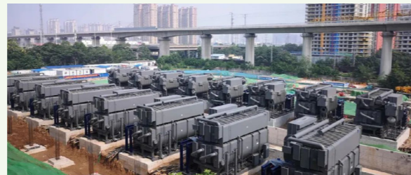
16 台 60MW 溴化锂换热机组
