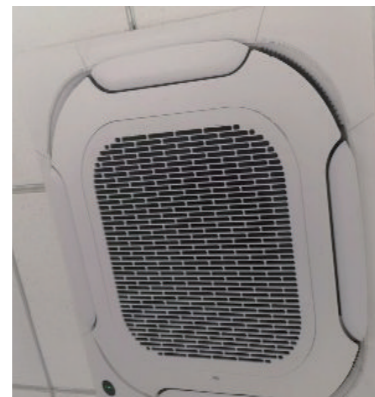
▲ 办公区更换一级能效空调
