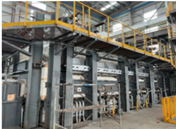
全氧配套 LNG 燃烧硅酸钠窑炉
