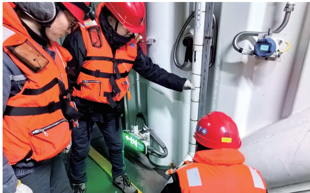
生产人员对海上升压站的设备设施进行防寒防冻专项检查
