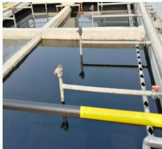
老厂废水站升级改造
