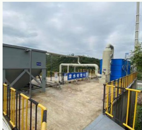
新厂设立废水处理站
