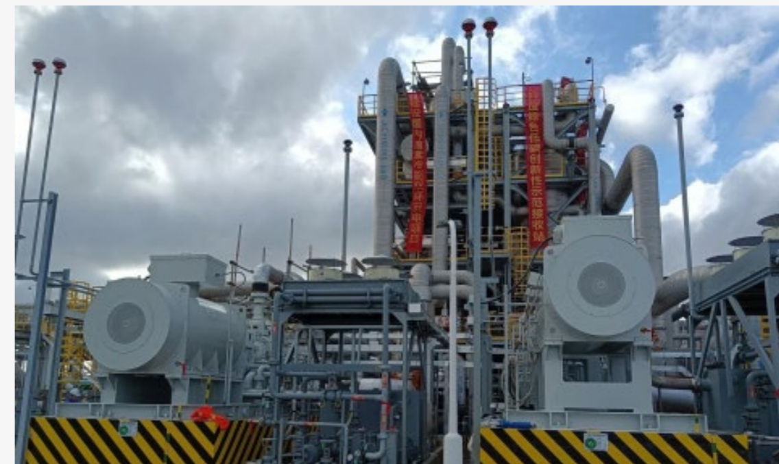
国内首套 LNG 冷能双环发电装置
