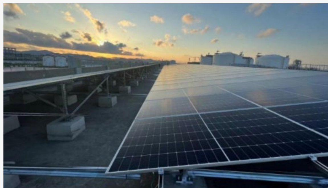
舟山接收站建设的光伏车棚
