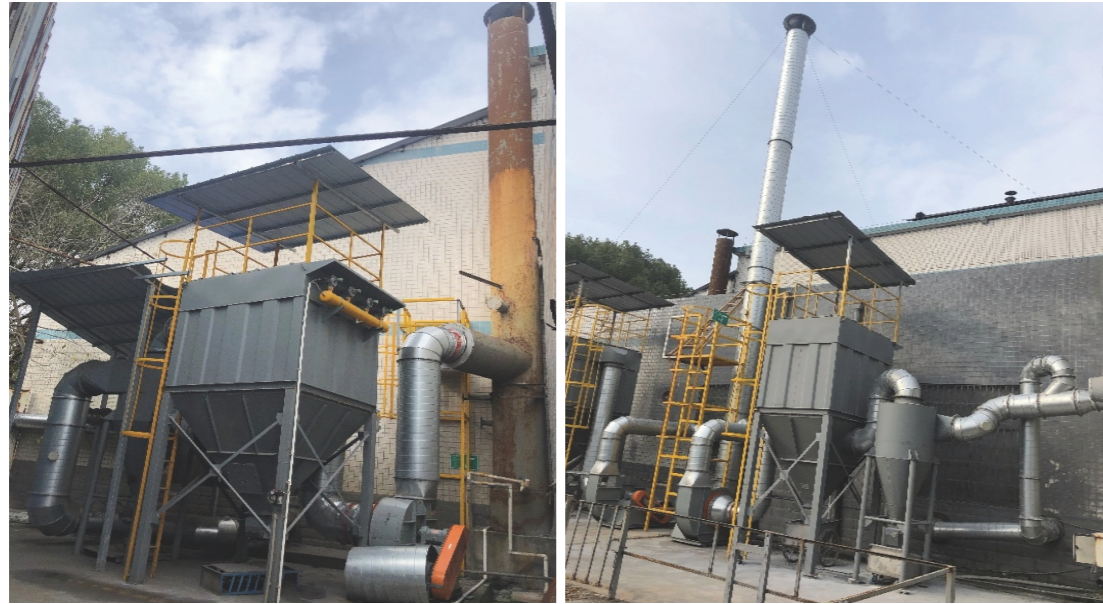
铸造厂抽风除尘设施
