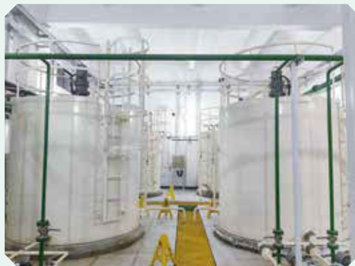
华能荆门热电排污水系统
