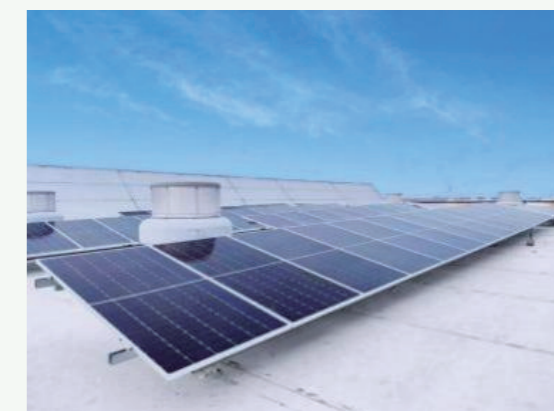
航空工业洪都12MW分布式光伏发电项目
