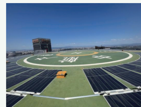
中航产融大厦分布式光伏发电系统
