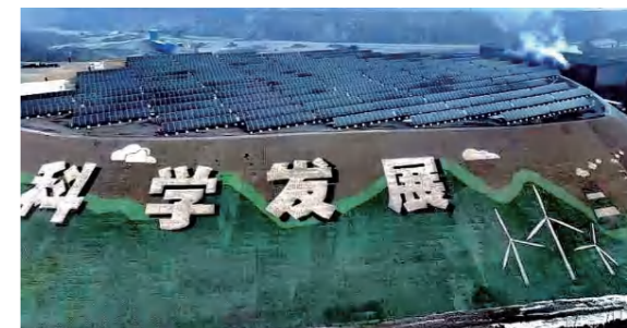
渣山分布式光伏项目
