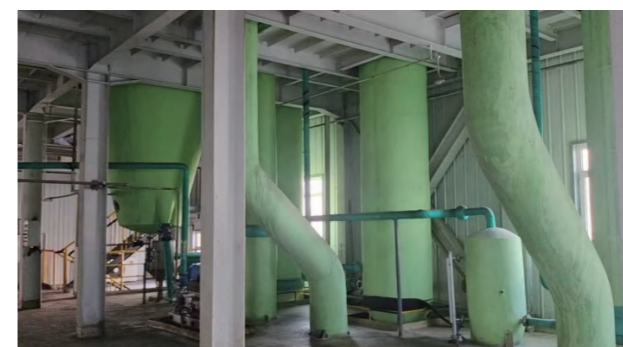
氯化铵废水蒸发设施
