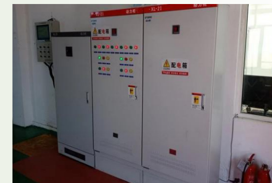
东铜铁路空气源热泵
