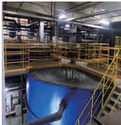
各废水处理系统沉淀池
