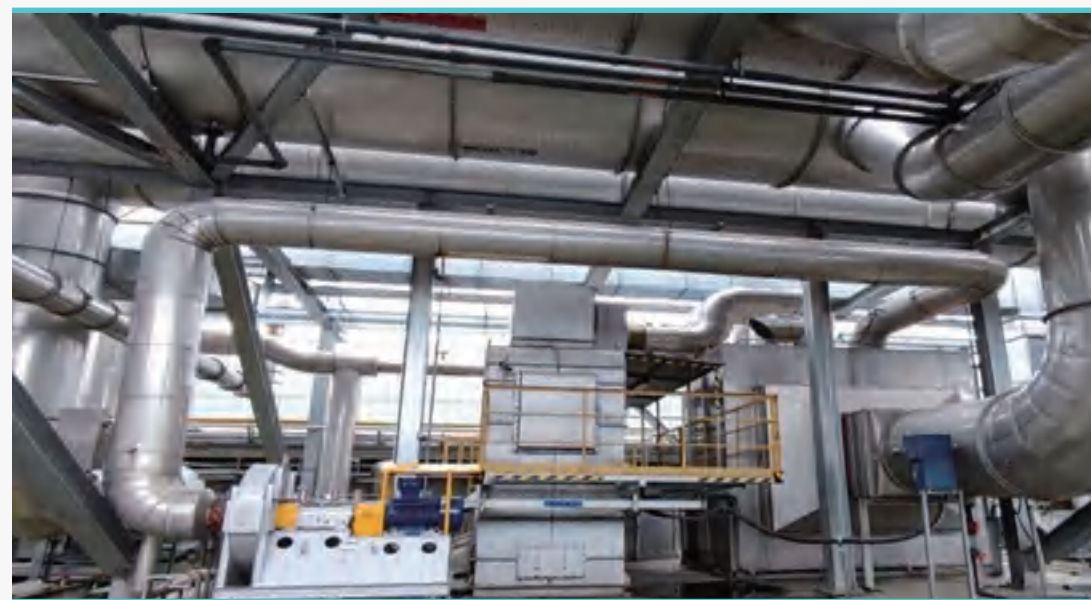
有机废气沸石浓缩转轮+RTO蓄热焚烧处理设施
