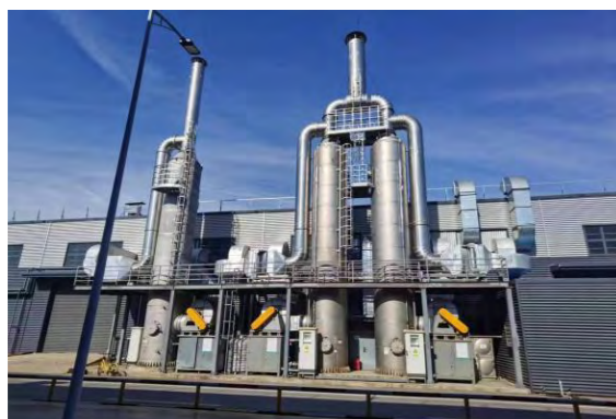
扬州基地废气处理设施
