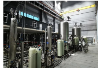
科学设施水冷系统
