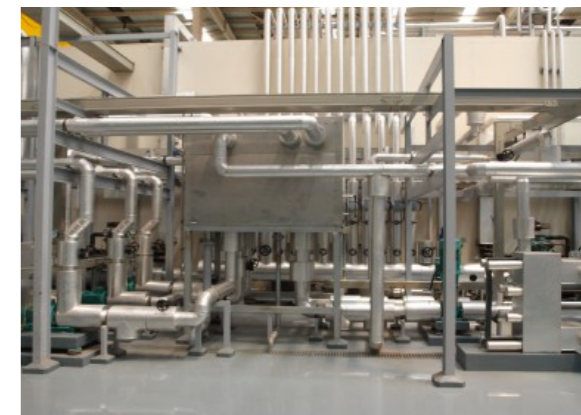
冷水机组试验装置热回收系统
