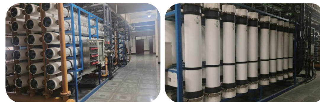
平高电气废水过滤设施
