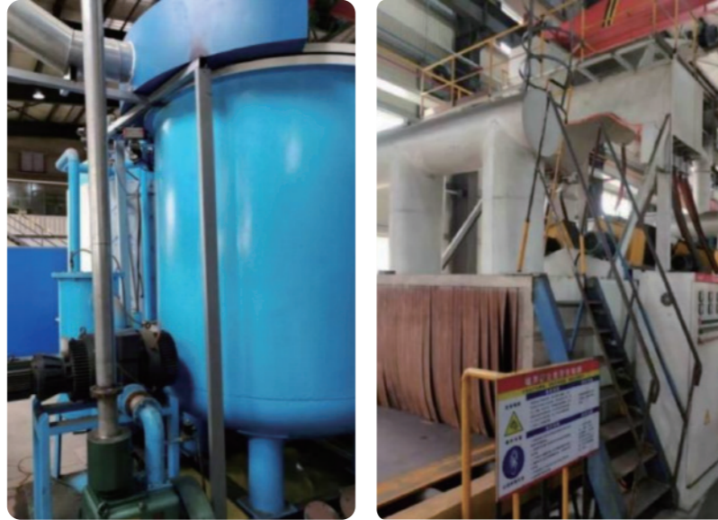
VOCs 治理设施
