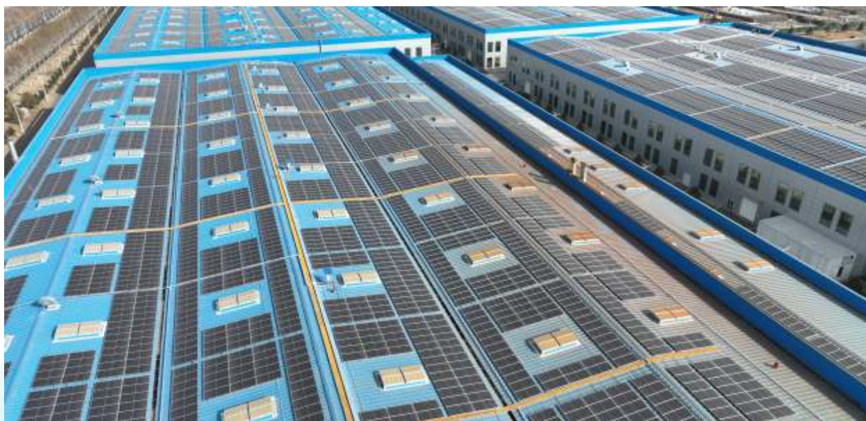
京津冀智能科技产业园11.5MW分布式光伏电站
