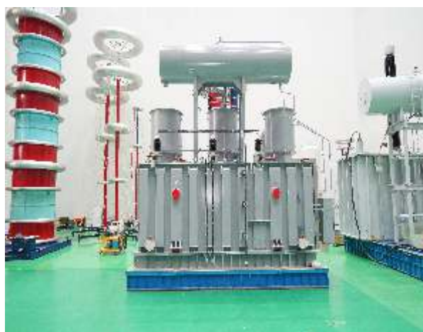
公司成功研制的500kV三相一体并联海上升压站电抗器
