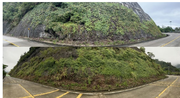
阳蓄电站上下库连接公路混凝土边坡生态复绿与植被恢复
