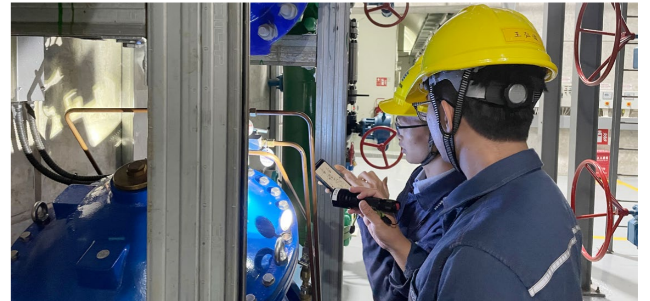
海蓄公司开展日常设备巡检工作
