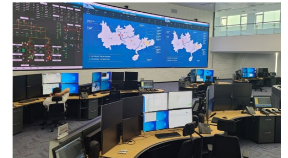
我国首个抽水蓄能多厂站集控中心
