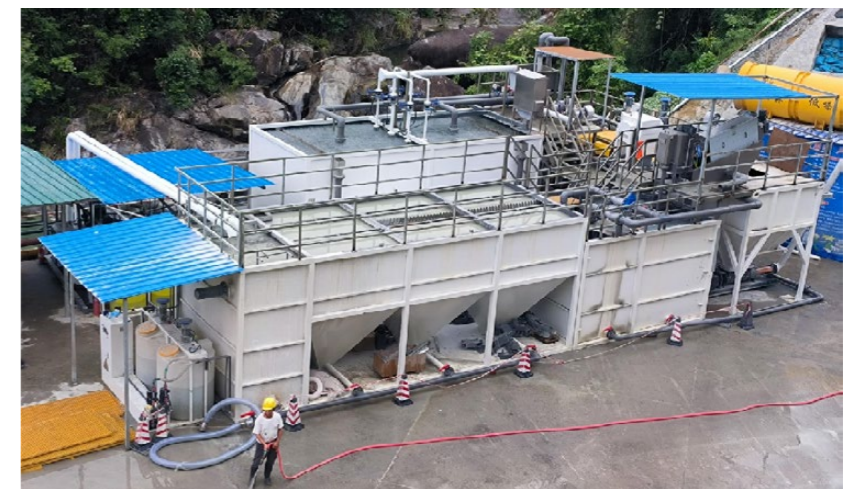
惠州中洞项目引进大型成套污水处理系统
