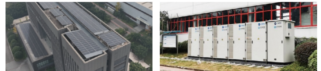
光储一体示范项目建成并上网
