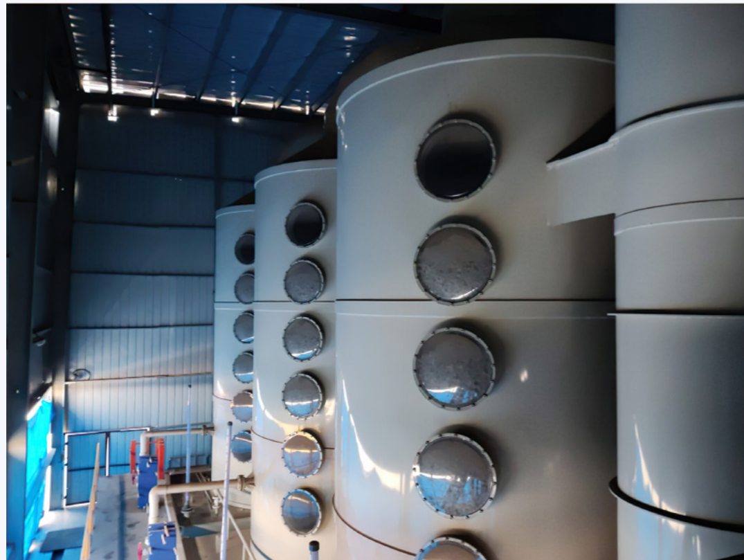
许昌地区工厂 EO 废气处理设施
