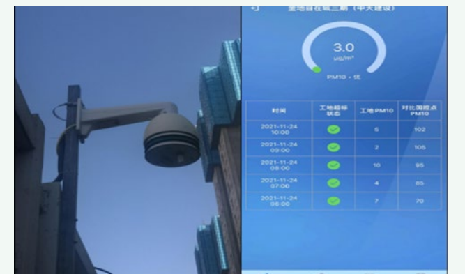
扬尘监测系统
