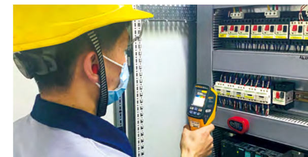
开展岗位级日常电气安全排查
