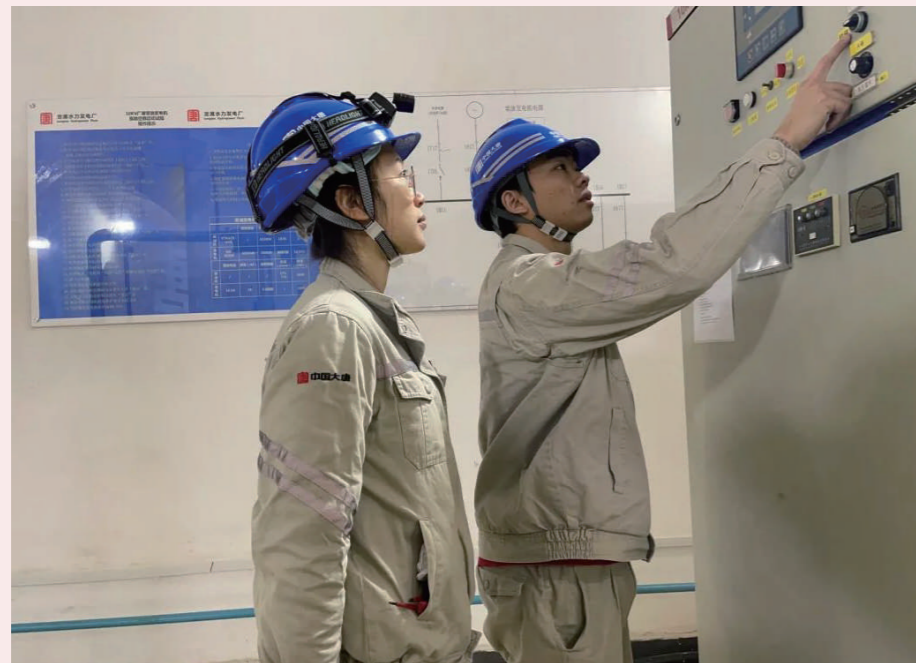
▲春节值班人员在对设备进行常规巡检
