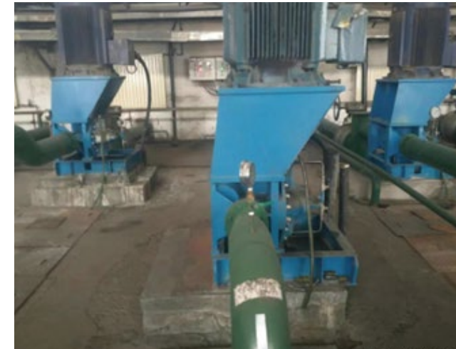
高效水泵运用
