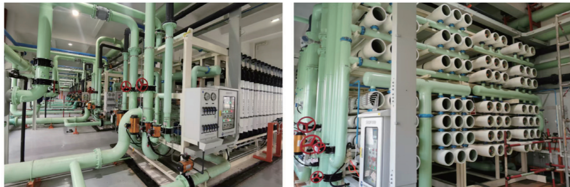
鸿山热电超滤反渗透系统改造项目
