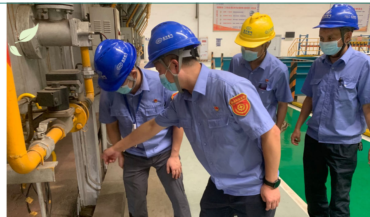
东方电气迅速开展四川泸定震后应急处置工作，组织专业技术人员有序对厂房、设备、边坡等重点部位、重点场所等进行全面排查
