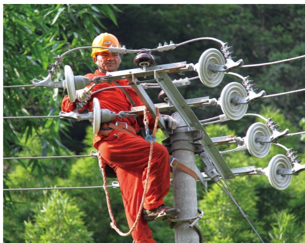
10 千伏峨眉普兴悦连支线改造工程荣获“国网百佳农网工程”称号
