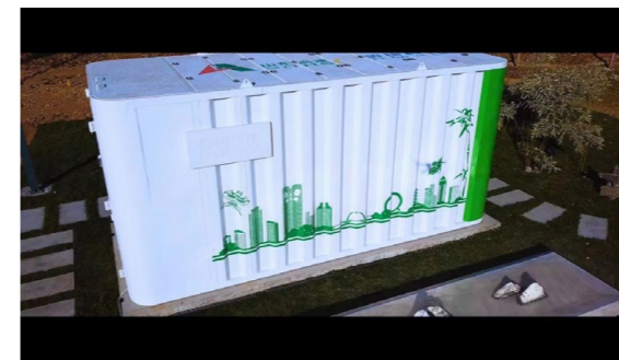
山东高速污水处理系统
