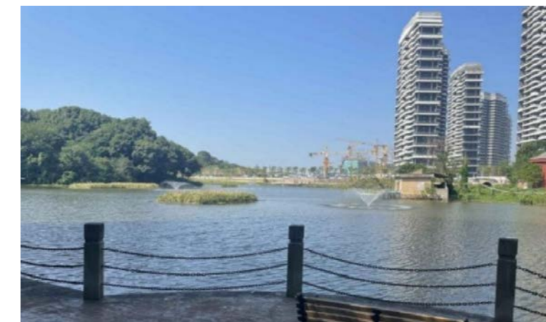
◎ 四公司完成承建的岳阳中心城区污水系统综合治理工程 PPP 项目二期工程中水体治理项目
