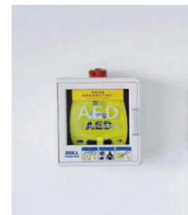
车间出入口 设置 AED 体外除颤仪
