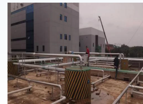
马金铺污水处理站尾气收集管网
