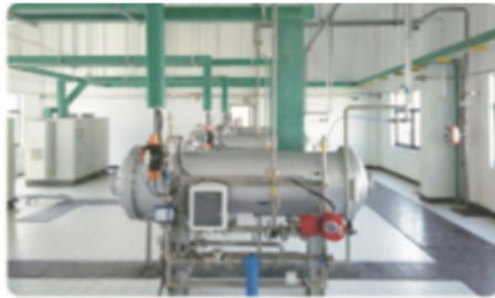
北京市郭公庄水厂 自来水深度处理工程
