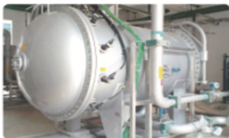
中石化茂名分公司 烟气除尘脱硫脱硝工程
