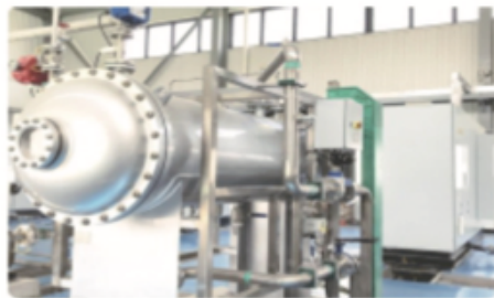
北京市通州水厂自来水深度处理工程
