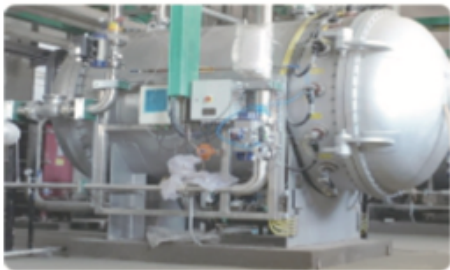
河北钢铁中厚板院烧结机锅炉 烟气脱硝工程
