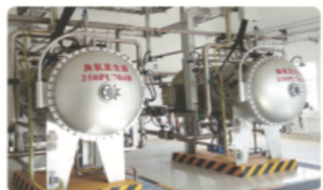
陕西未来能源RO浓水处理工程
