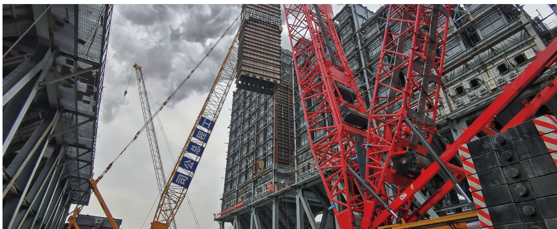
陕钢集团汉钢 2×265 m 2 烧结烟气综合治理提升改造项目
