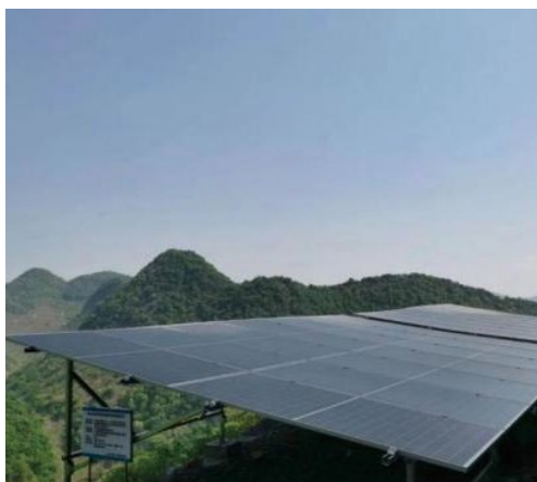
长沙院光伏灌溉项目建成落地
