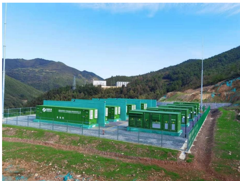
图 2：湖南祁东大马风电储能 10MW/20MWh 项目
