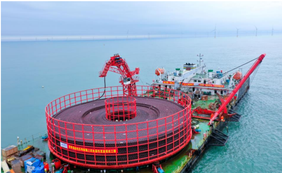
图 1：中天科技承制并敷设施工的±400 kV 直流海缆的顺利交付运营
