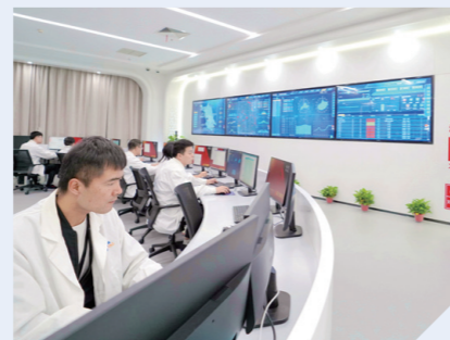
开展新一代调度技术支持系统试点项目研发攻关
