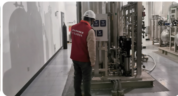
换流阀水冷系统例行检查
