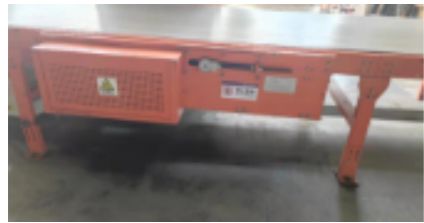
设施设备安全警示标志全覆盖
