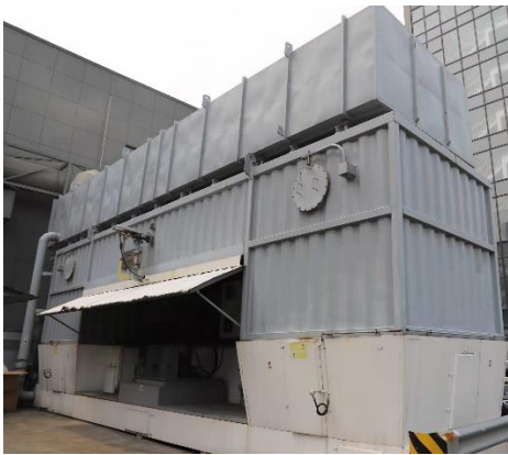
喷漆车间废气处理设施-蓄热式热氧化技术(下称“RTO”);全密闭喷漆线体废气收集率达95%,RTO处理率达90%
