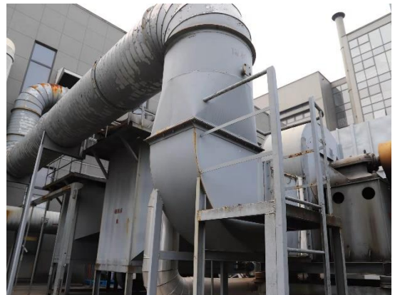
喷漆车间废气处理设施-蓄热式催化燃烧技术(下称“RCO”);全密闭喷漆线体废气收集率达95%,RCO处理率达90%
