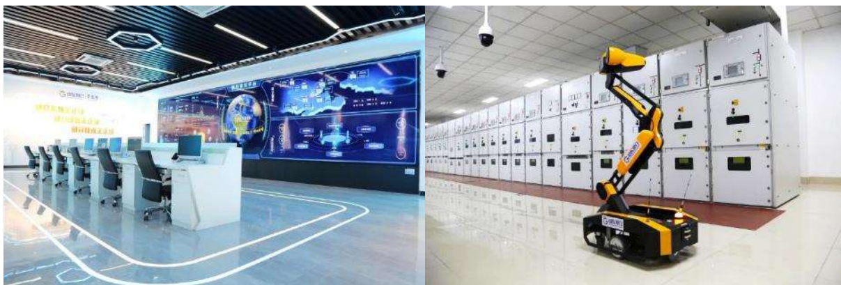
供电系统智能调度指挥中心
