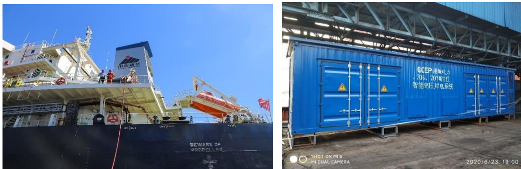
图：秦港股份岸电设施正在为靠港船舶提供用电
