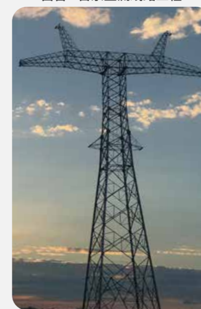
昌吉 - 古泉直流线路工程
