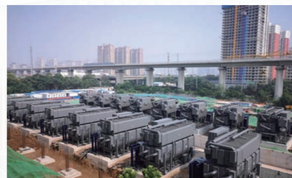
石热中继能源站
